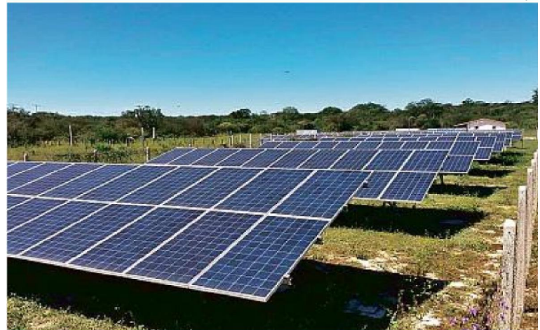
O custo do aluguel de energia solar depende do número de painéis fotovoltaicos e quilowatts contratados
