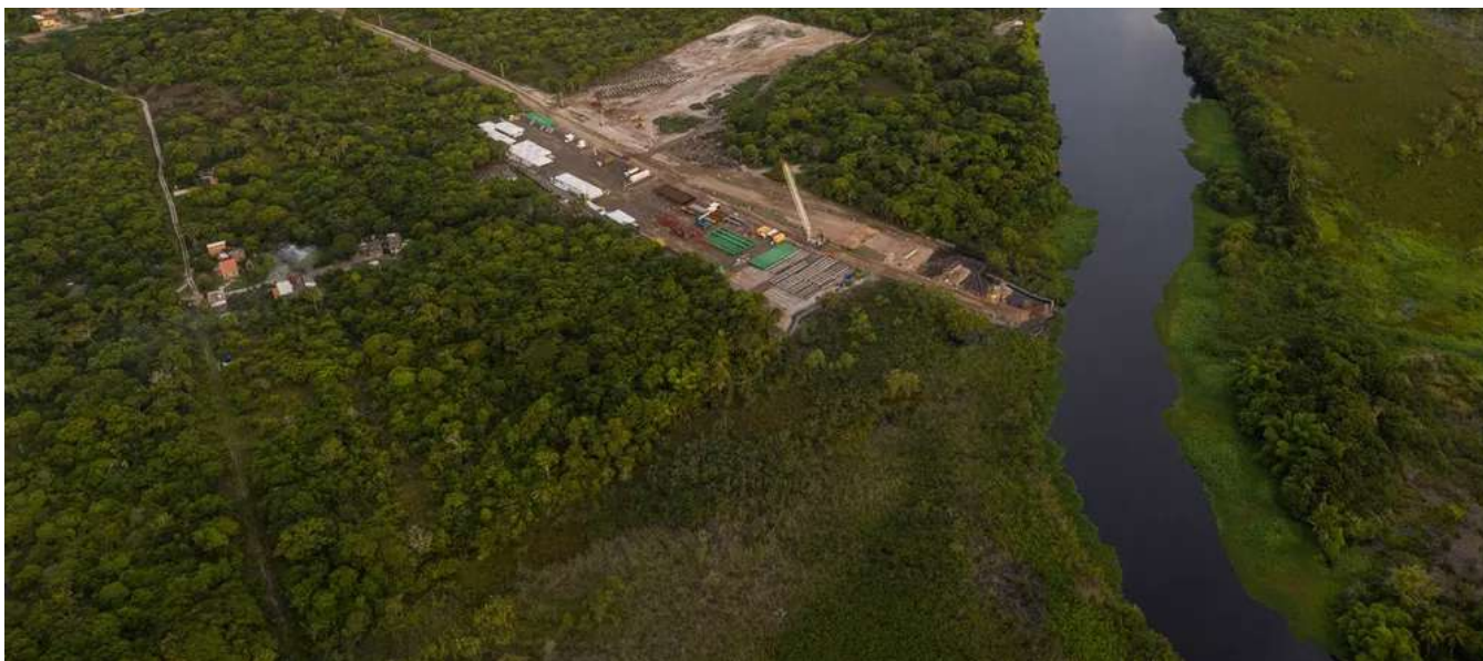
Canteiro de obras do Porto Sul, o rio Almada e a Mata Atlântica: projeto controverso que enfrenta resistência há 15 anos — Foto: Markus Mauthe/Divulgação
